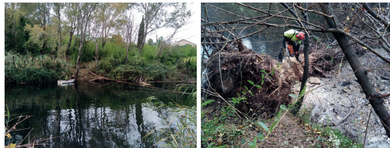
Travaux en cours au niveau du Pont d'Argens et le long de la RD84 entre les Moures et les Bertrands
